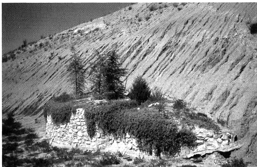
FIG. 10.—Autovía Madrid-Valencia (abril, 2000) en las proximidades de Valencia. Se observa que no existe control de erosión. Las plantaciones son puramente ornamentales.
